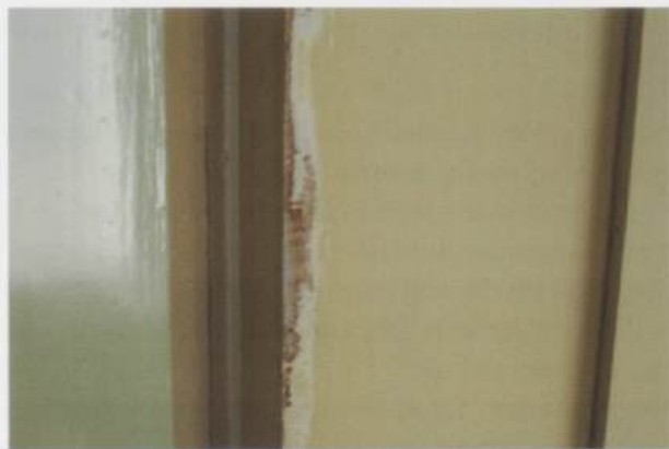
Vrijliggende verflagen door slijtage (foto auteur)
