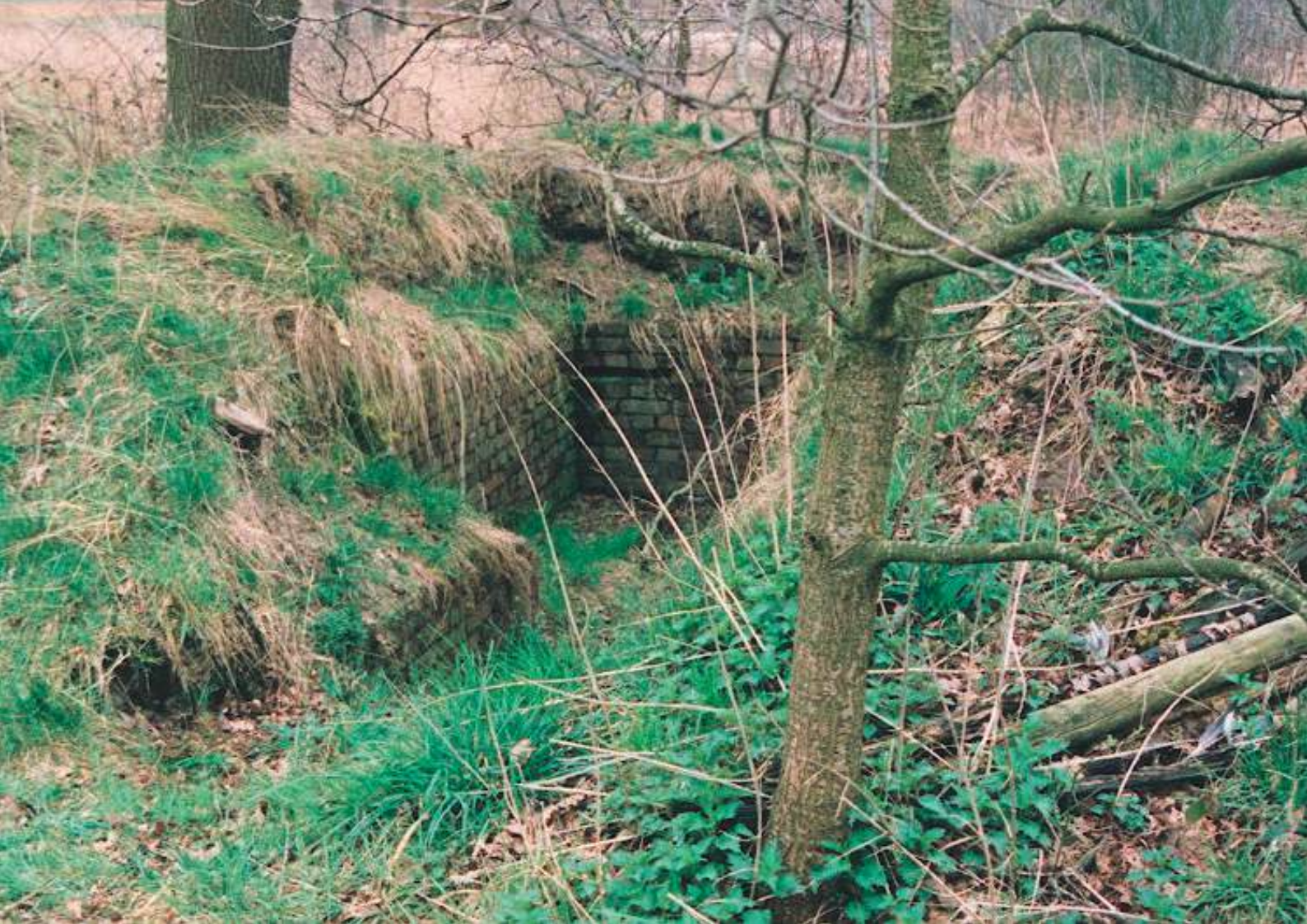
De bunker zoals hij er bij lag voor de renovatie. (Foto: archief Stichting Old Beltrum)
